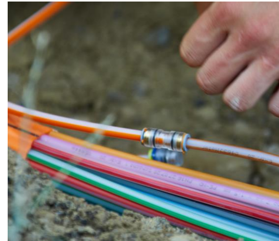
Glasfaser-Kabel zum Haus
